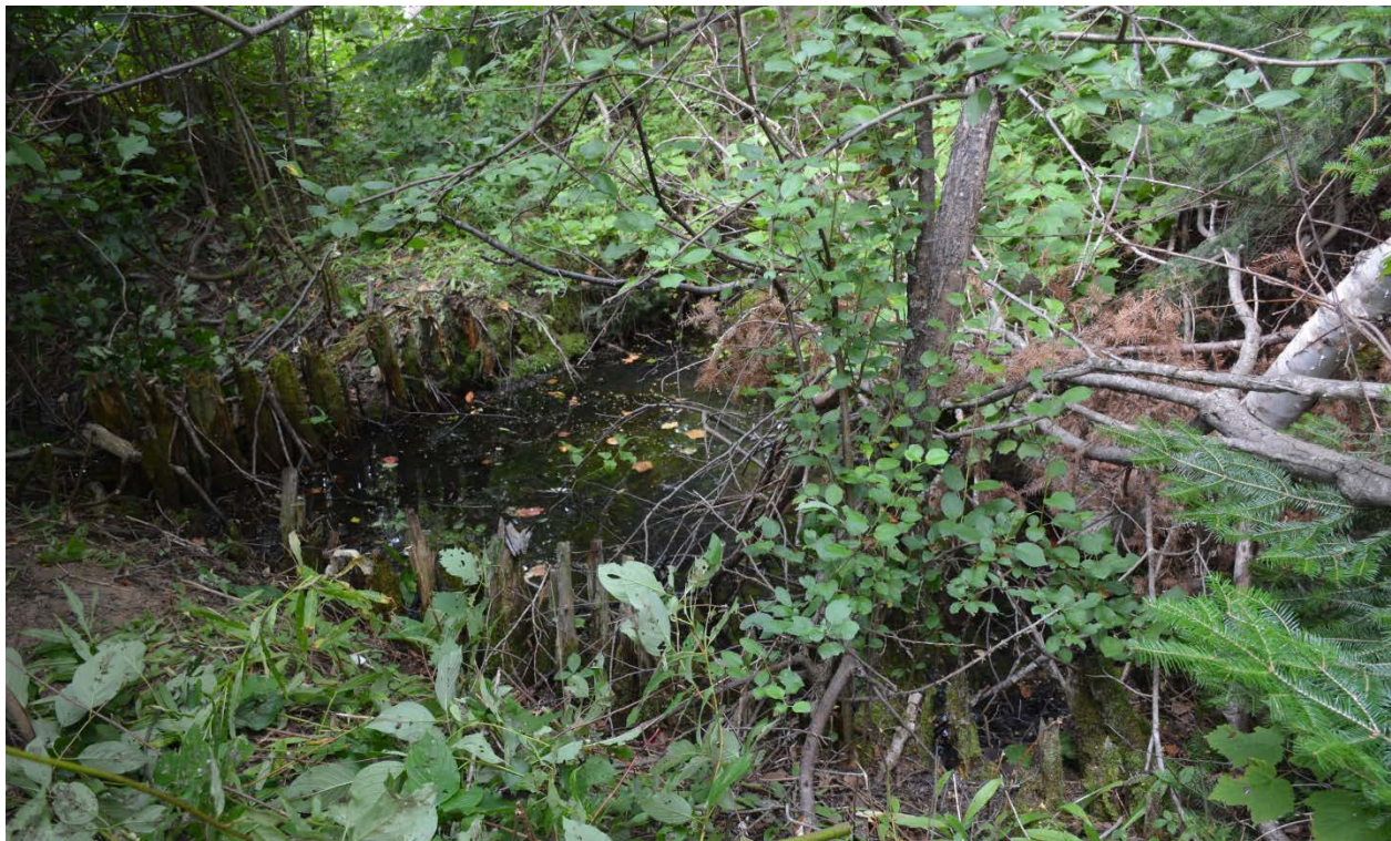
Figure 19. Vestiges inondés d'un petit bâtiment, au sud du Dépôt à Soucy.
